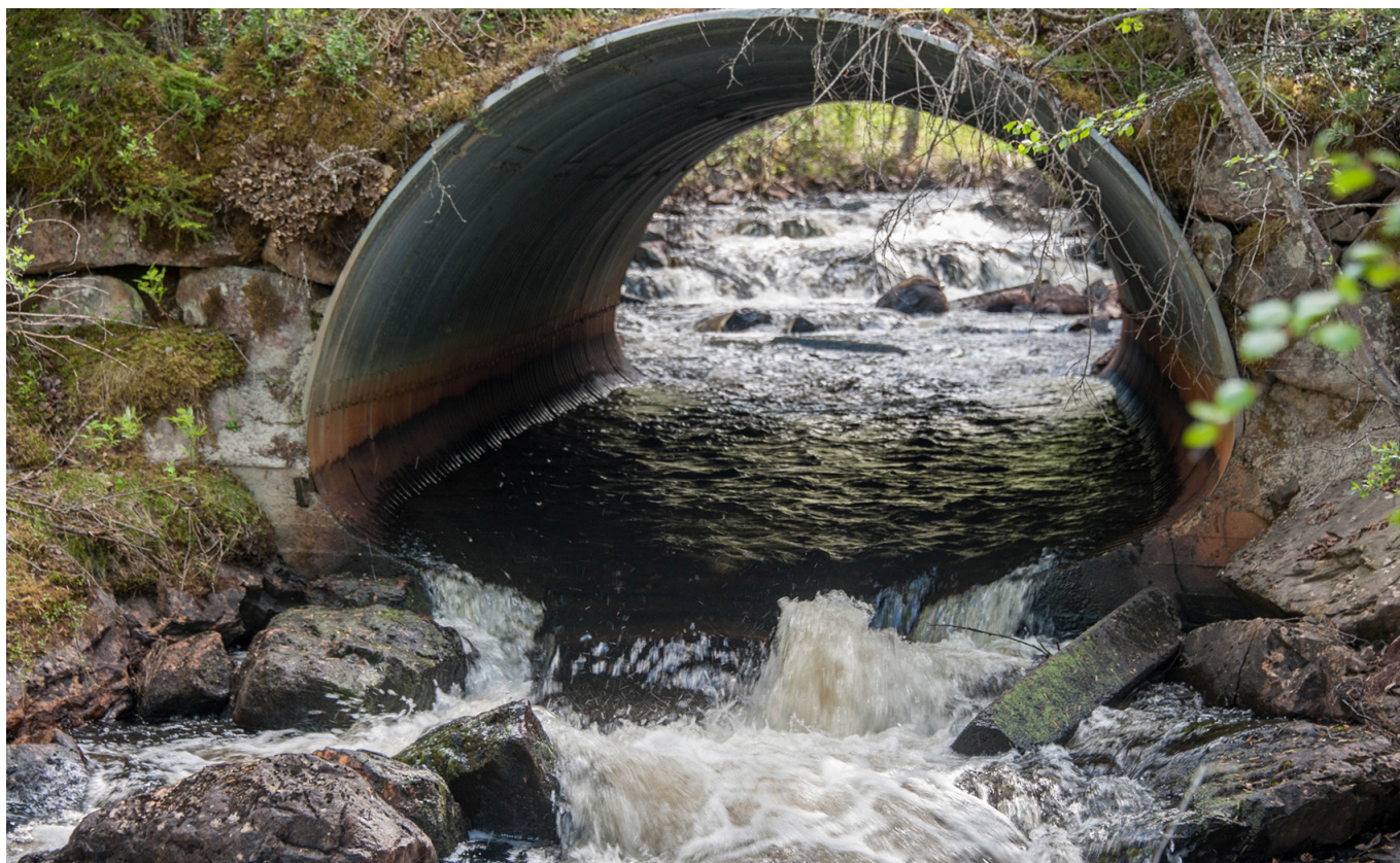
Rätt anlagda vägtrummor är viktiga för vattendragens biologiska mångfald.
